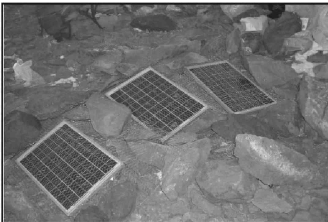
Figura 3. Paneles Solares y malla de alambre que los sujeta
